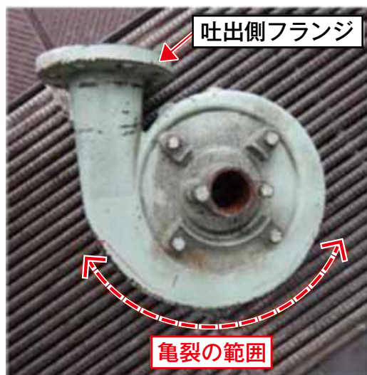
写真 2-14 冷却海水ポンプのケーシング (電動機側面)
