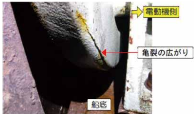
写真 2-16 ケーシングに生じた亀裂の広がり (冷却海水ポンプが本船に取り付けられた状態)
